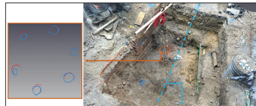
钢筋横向切割展示了摄影测量与地面激光扫描 (TLS) 技术在准确度上的比较：蓝圈表示摄影测量，红圈表示 TLS；最大偏差约为 6-10 毫米。
