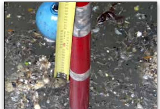
乌鸦巢镇其中一个排污质量差的泵站
